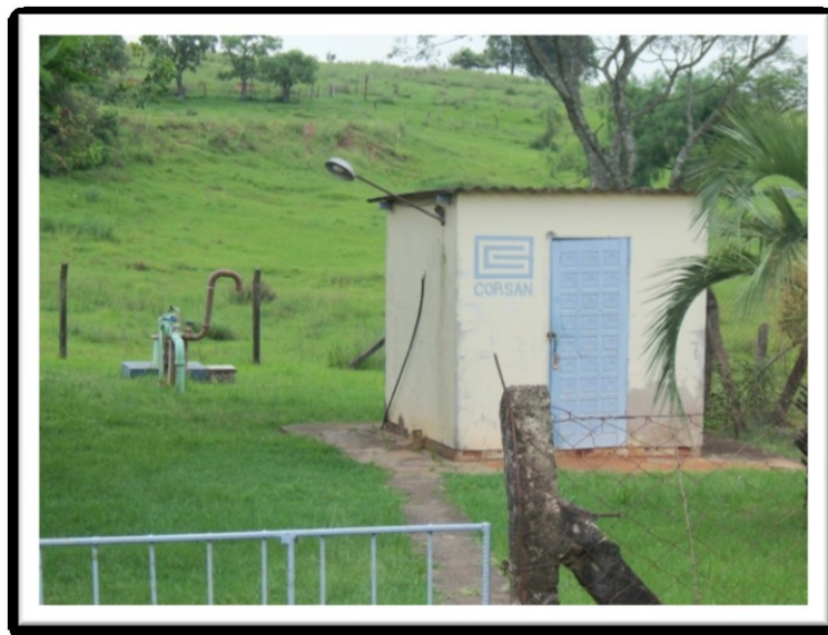
Figura 33: Poço artesiano da CORSAN na Rua Ulisses Bastos de Aguiar, Bairro Vila Nova. Fonte: PMSFA
